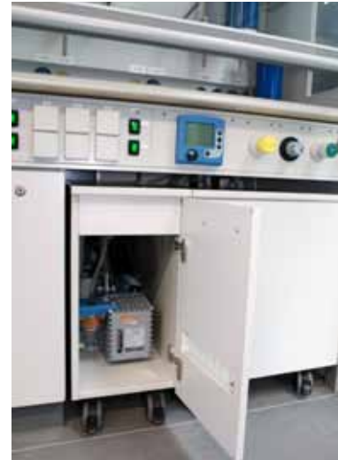
Einzelplatzversorgung: Feinvakuum, Schlenkline
