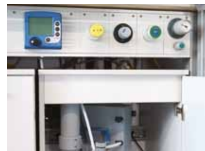
Installation im Unterschrank mit Regelmöglichkeit im Griffbereich
