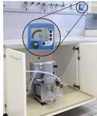
Chemie-Netzwerkpumpstand unter dem Abzug, mit Lösemittlrückgewinnung, Bedienung über die Medienkonsole
