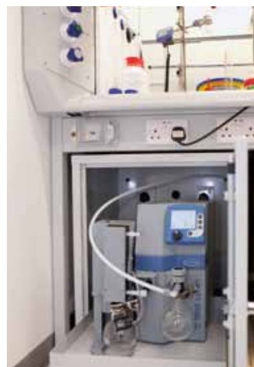
Groupe de pompage «chimie» en réseau sous la hotte, avec récupération des solvants
