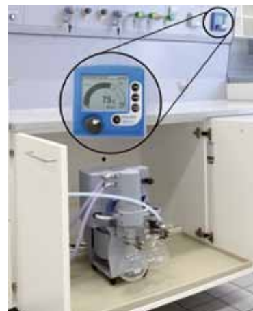
Groupe de pompage « chimie » en réseau sous la hotte, avec récupération des solvants, utilisation via un pupitre de commande
