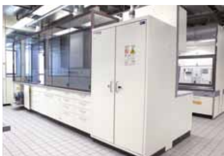
Approvisionnement en vide de plusieurs postes de travail, avec hotte de sécurité
