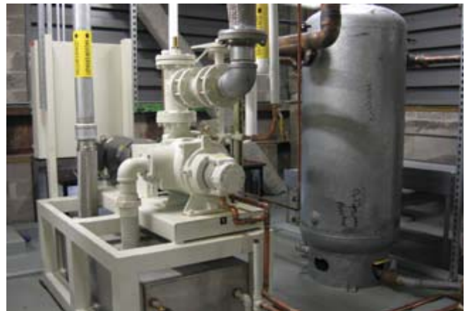
Großes zentrales Vakuumsystem mit Pumpe und Pufferbehälter
