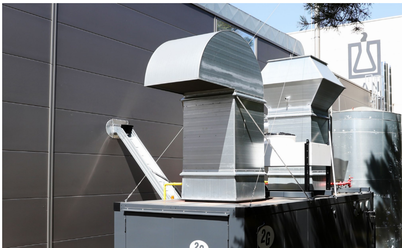
Blockheizkraftwerk bei BRAND KG
